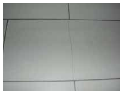
Afb.2 Doorlopende scheuren in de aangrenzende tegel.
