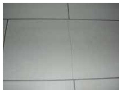
Fig. 2 Continuité d'une fissure dans la dalle adjacente
